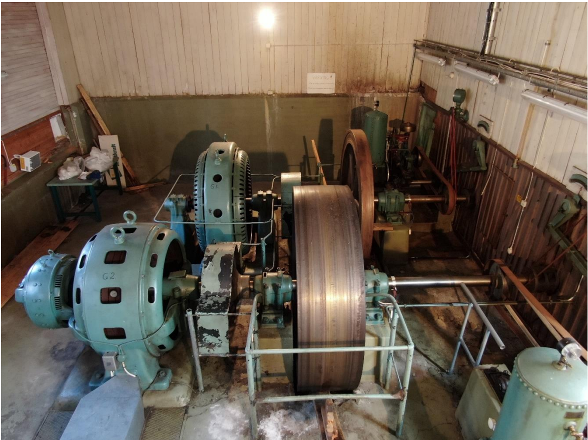
Figur 16. Interiört foto från kraftstationen som visar de båda generatorerna.
