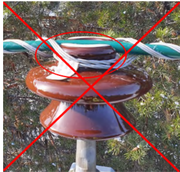
EJ korrekt montage
